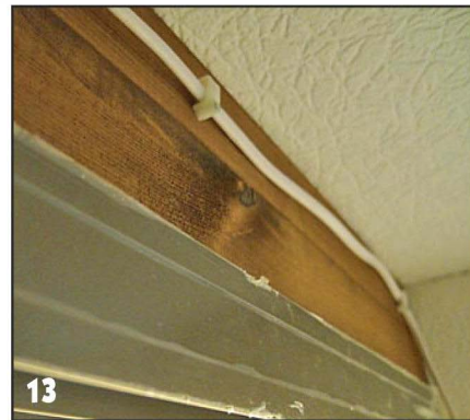
Проводка к светильникам проложена с тыльной стороны потолочного бруска.
